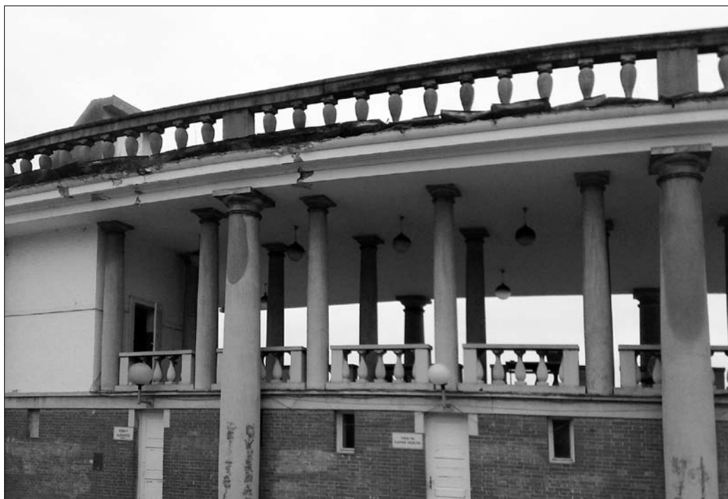
Poškodbe pločevinaste obrobe po odstranitvi žlebov, november 2008
